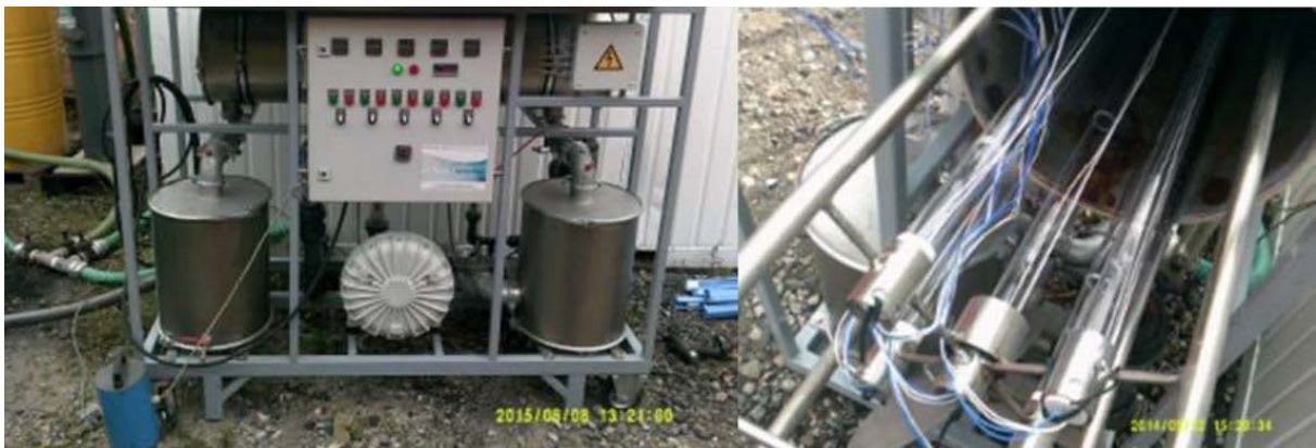
Bild 7.5: Pilotanlage zur Abluftreinigung mittels biologischem Abluftwäscher und vorgeschalteter UV-Oxidation/-Katalyse (Foto und Praxisbetrieb: IBL UMWELT- UND BIOTECHNIK GMBH)
