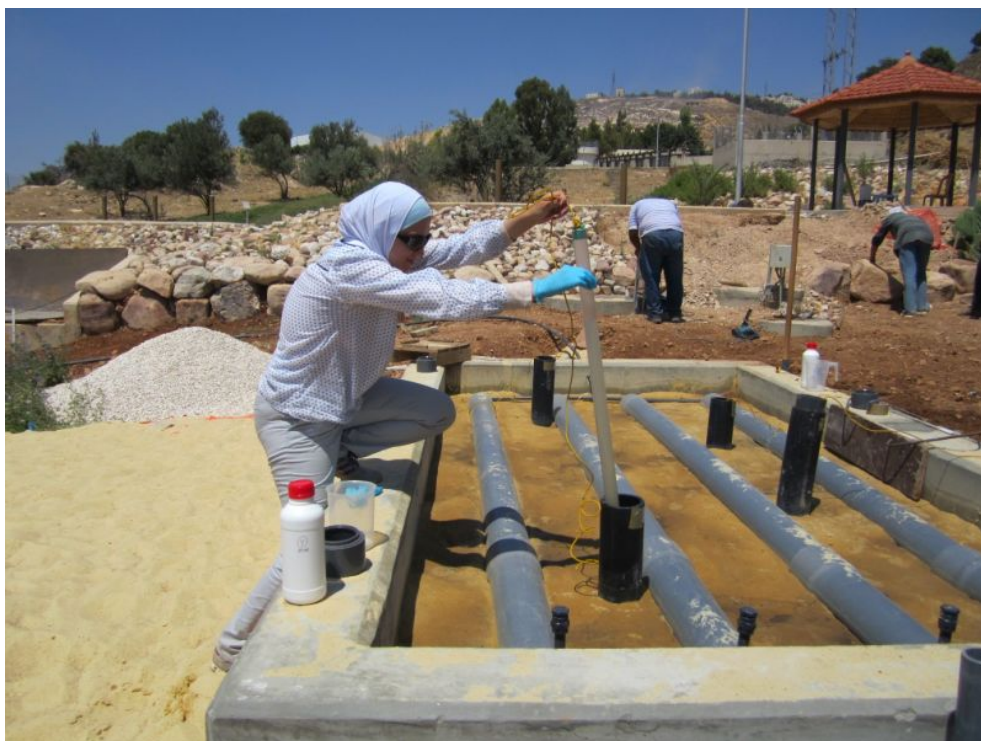
Bild 7.6: Demonstrations- und Testanlage zur dezentralen Wasseraufbereitung in Fuheis (Jordanien) - Inbetriebnahme eines Versickerungsbeckens durch das TZW
