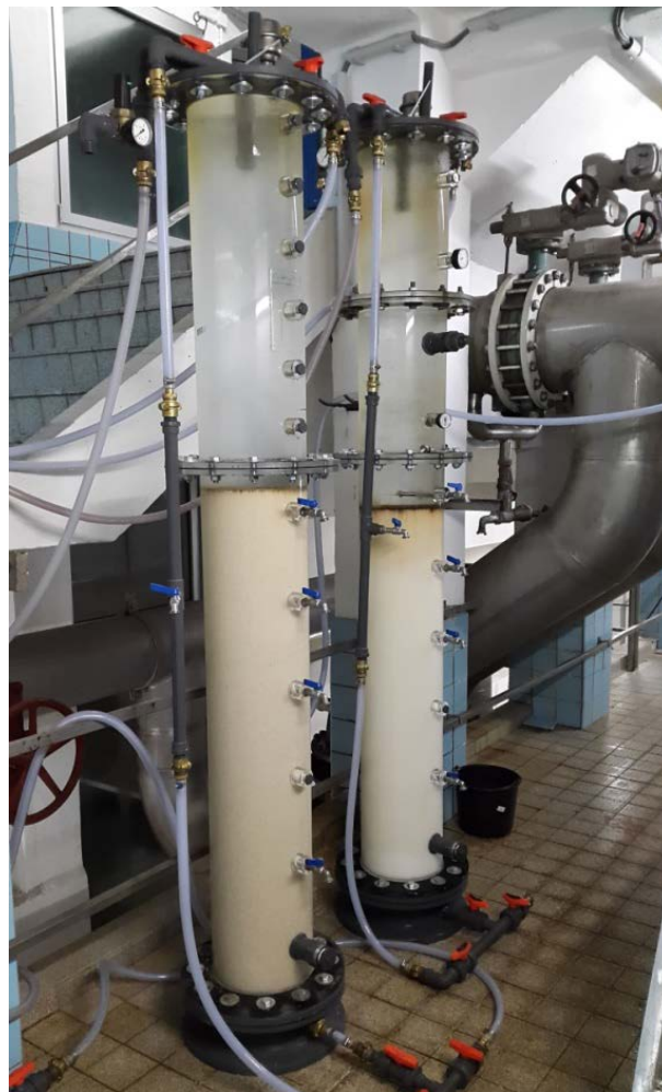
Bild 2.3: Versuchsanlage zur Entsäuerung und Aufhärtung mittels Kalkpellets
