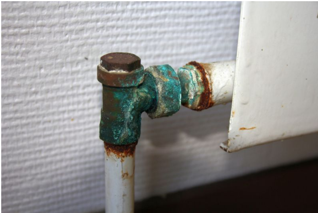
Bild 2.14: Korrosionsschaden an einem Heizkörperanschluss
