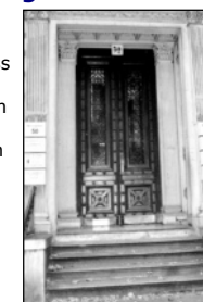
Typisch: Treppen am Praxiseingang.
