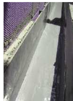
Überlaufrinne mit Beschichtung © StekoX® GmbH
